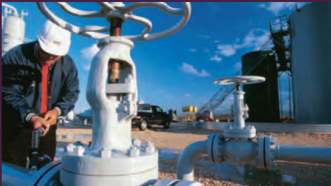
Station de pompage de gaz naturel en Amérique du Nord.
