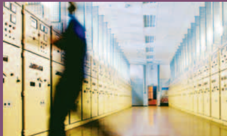
Vérification des armoires électriques de 13,2 kV dans un poste électrique de Buenos Aires.
